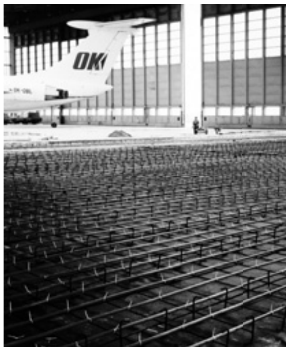
Напольное отопление для промышленных зданий
